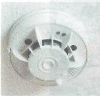
1：自動火災報知機
